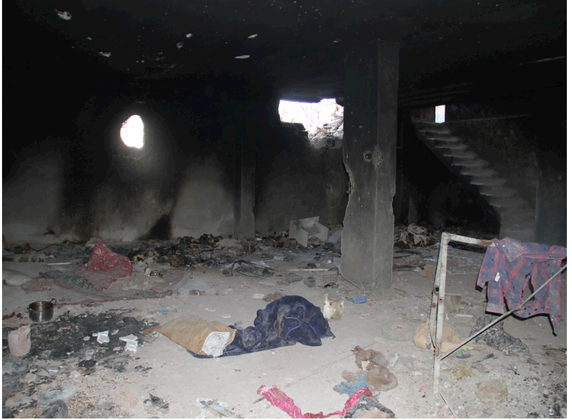
Üçüncü Vahşet Bodrumu'nda yaralıların sığındığı bodrum katı. Bodrumdan kurtulan her iki tanık da yaralıların bodrum katında, yaraları hafif olan ve sağlam olanların ise üst katta kaldığını belirtmiştir.
